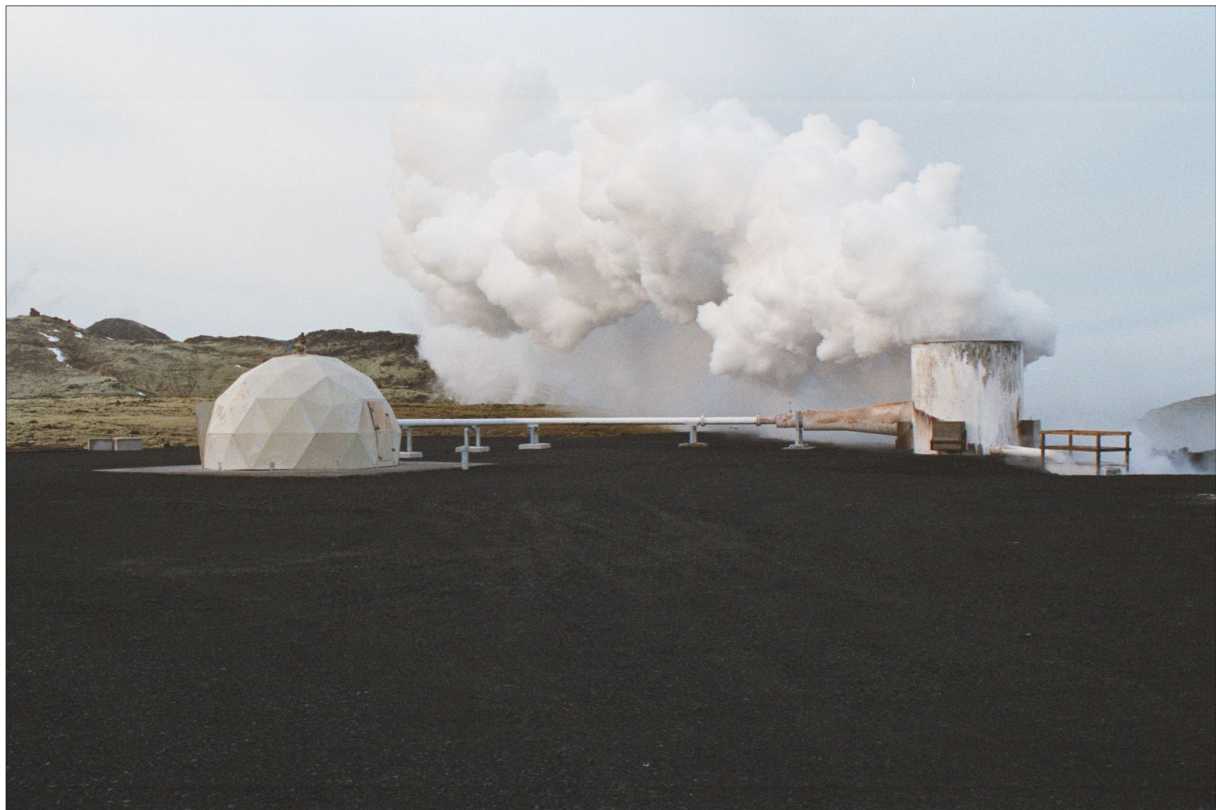
Mynd 4.4 Hefðbundinn frágangur borholu. Kúluhúsið er yfir sjálfa borholuna og gufan rýkur út um hljóðdeyfinn. Hægra megin við hann rennur affallsvatnið út.
