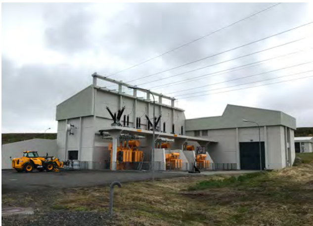
Steyptar stoðir rísa upp úr tengivirkisálmu stjórnhússins og frá þeim liggja háspennulínur, 2020.
