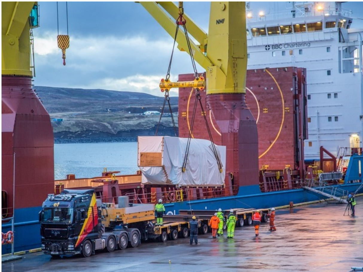
MYND 9 Rafall fyrstu vélasamstæðu Þeistareykjavirkjunnar hífður af borði flutningsskipinu BBC Polonia í desember 2016. Ljósmynd: Landsvirkjun.
