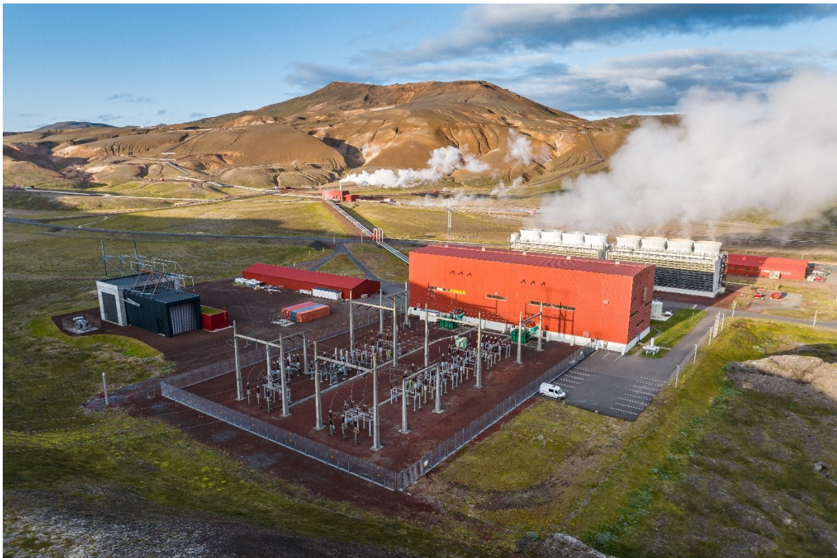
MYND 11 Mannvirki Kröflustöðvar. Mynd: Landsvirkjun.
